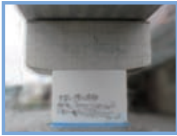
橋脚柱の落書き
