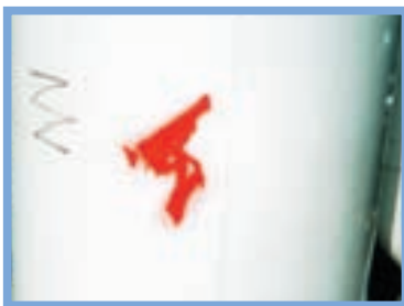
歩道橋橋脚の落書き
