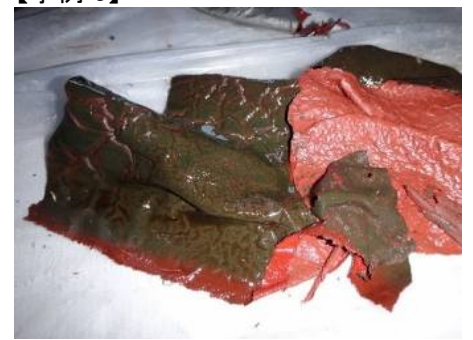
はく離除去後の塗膜状態
